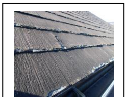
屋根材の劣化
