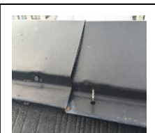
棟板金の浮き
