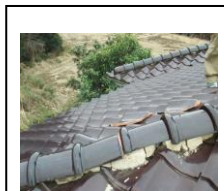
屋根漆喰の劣化
