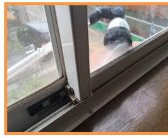
☑窓サッシから雨漏りする
