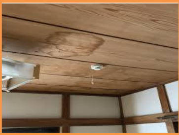
☑天井や壁にシミがある
